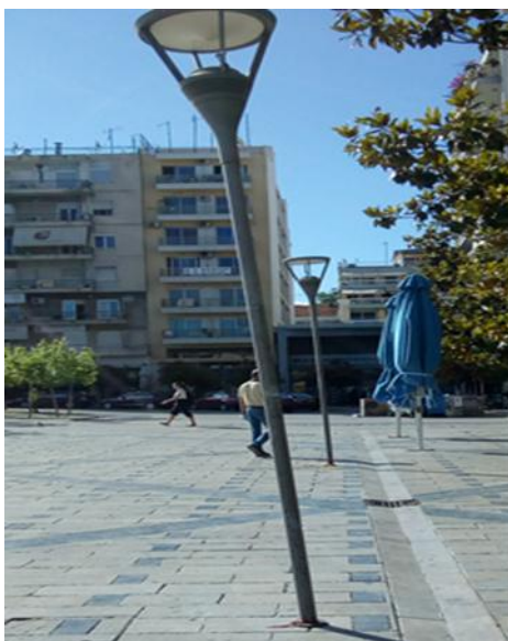
Φωτιστικά στα οποία θα γίνει αντικατάσταση του ιστού.
