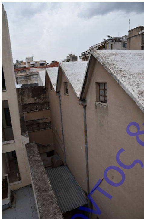
ΦΩΤ. 21: Ακάλυπτος Χώρος – Η/Μ εγκαταστάσεις
