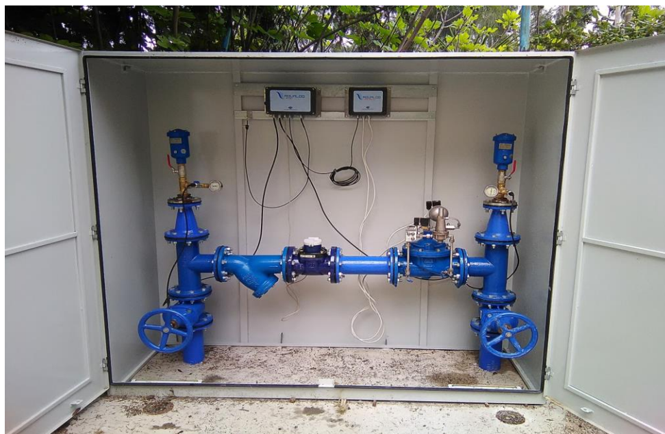
Εικόνα 18: Σταθμός ελέγχου παροχής/πίεσης ζώνης
